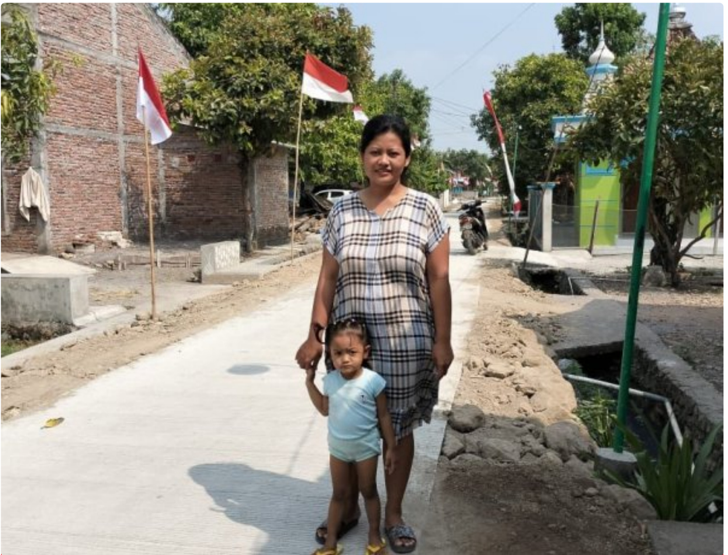
Diah Arum Warga Desa Cangkring RT 5 RW 1 Huniannya Dilewati Pengecoran Jalan Program TMMD
